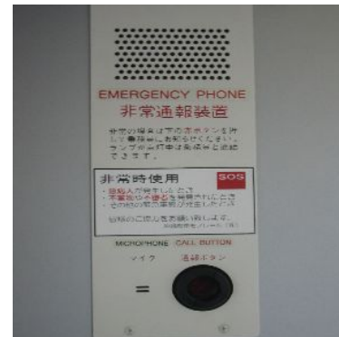
車両連結部 非常通報装置
