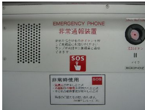
車椅子スペース側 非常通報装置
